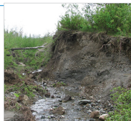
Érosion importante du talus qui pourrait devenir problématique.
